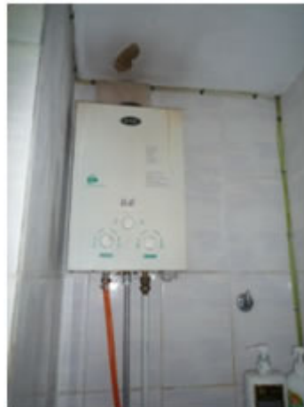
未經機電工程署批准及沒有裝置煙道
